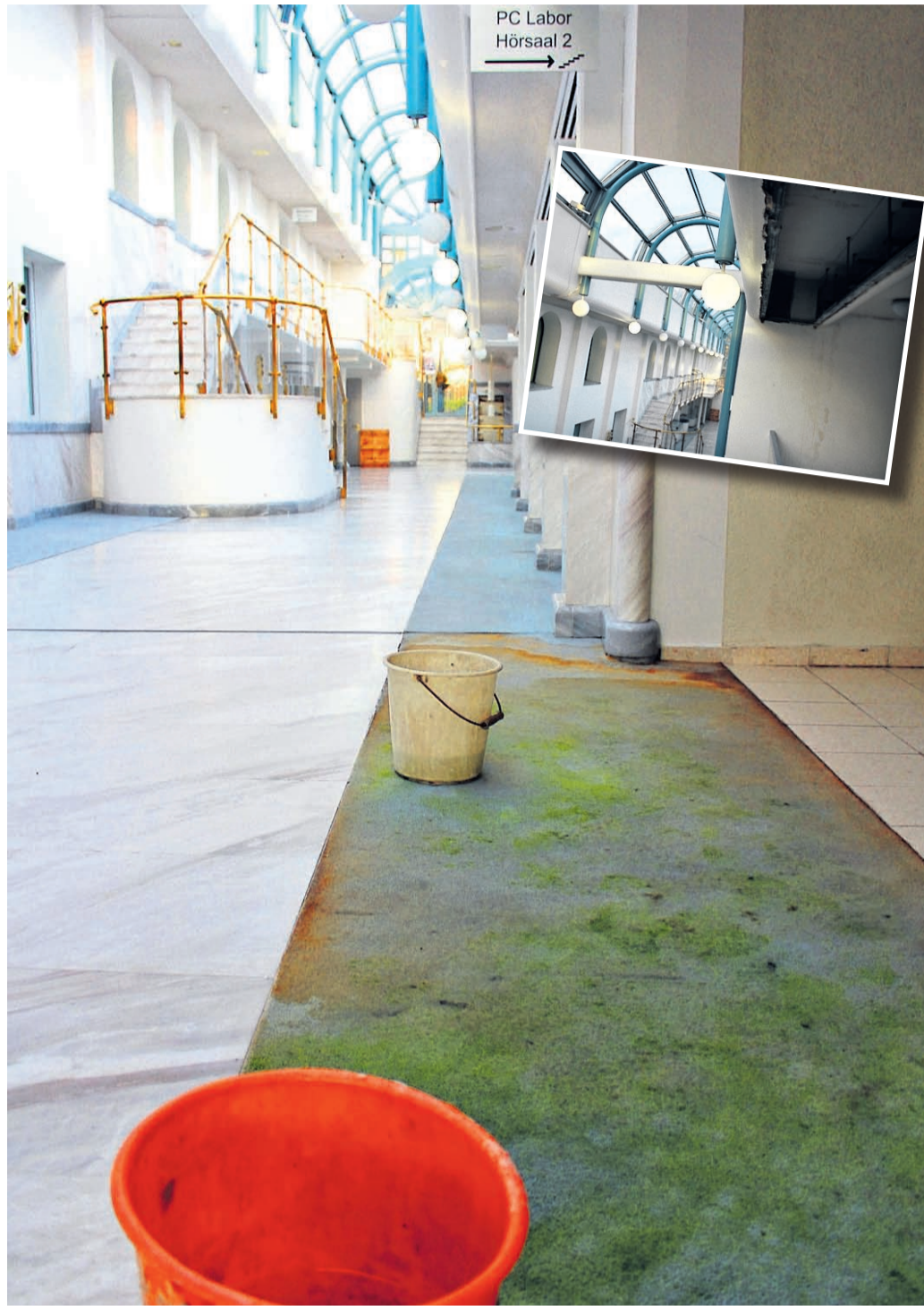
Die Sanierung des Kurhauses ist Zukunftsmusik, aktuell dagegen ein neuerlicher Schaden am Dach. Im Trakt der Hochschule fangen Eimer das Wasser auf. Dachdecker sind bestellt. Foto: Schuldt
